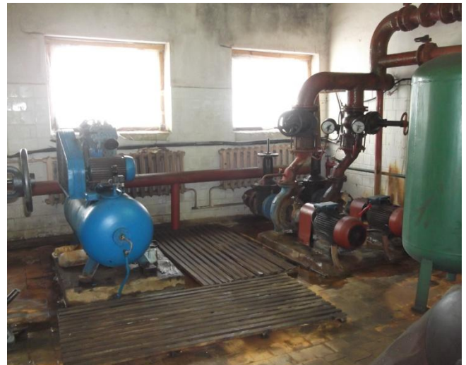
Оборудование для смесителя
